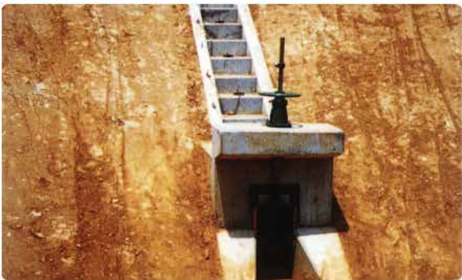
土砂吐ゲート
